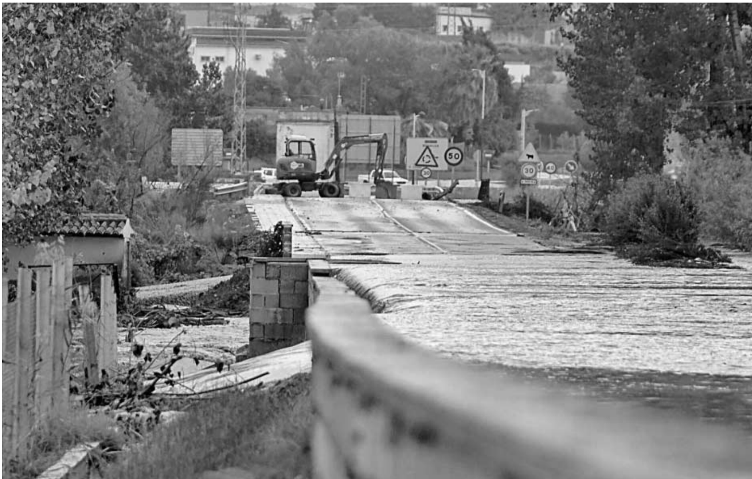
El río Guadix ha destrozado e inutilizado el puente entre Benalúa y El Bejarín.
